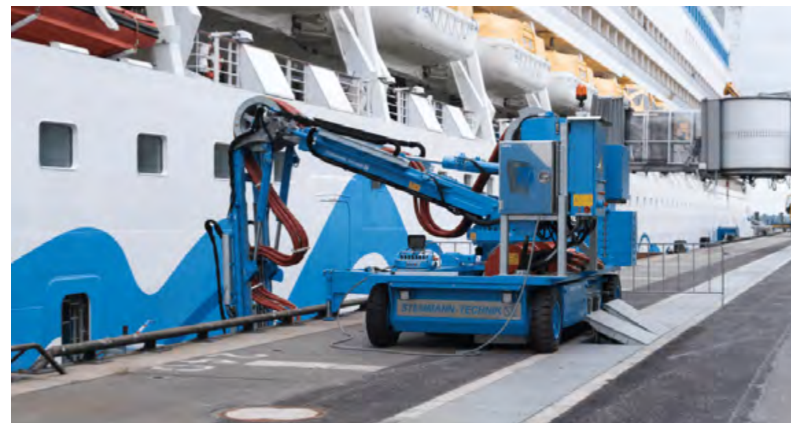
Ejemplo de carga de suministro eléctrico a un crucero (Stemmann-Technik).
